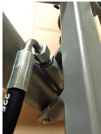
Senkregler am HTW eingebaut
